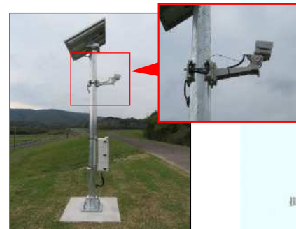
簡易型河川監視カメラ
