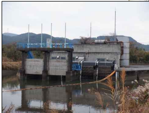
湯島排水機場
