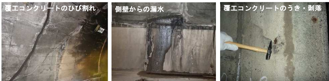
図 1-8 トンネル本体工の損傷事例
