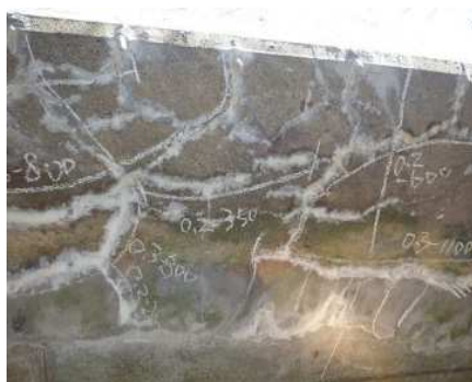
写真-亀甲状のひび割れ、遊離石灰
