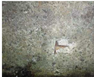
写真-鉄筋露出
