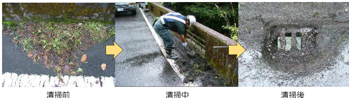
写真一 日常点検時の清掃状況(排水装置土砂詰り)
