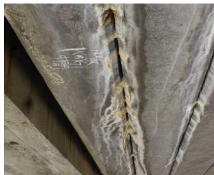
写真-錆汁を含んだ遊離石灰
