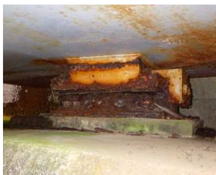
写真-支承部の腐食
