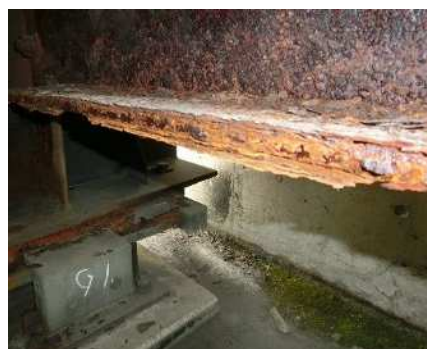
写真-主桁の腐食
